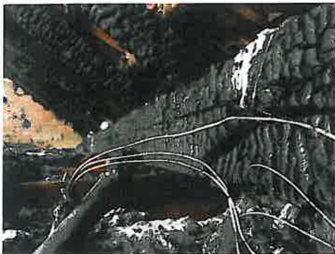
Ausgebrannter Dachstuhl – Elektrischer Defekt?
